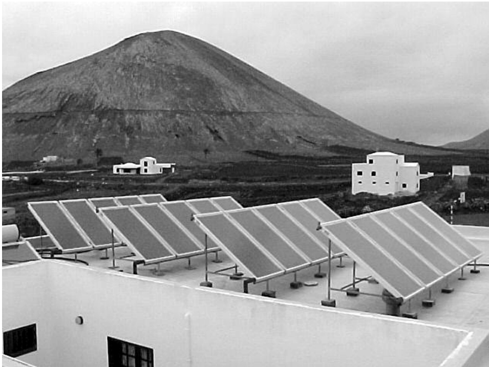
Instalación Solar Térmica Forzada (gran superficie de colectores).
