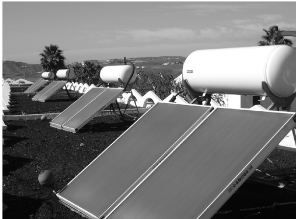
Grupo de Equipos Solares Termosifónicos para apartamentos turísticos individuales. Ramón García Déniz
