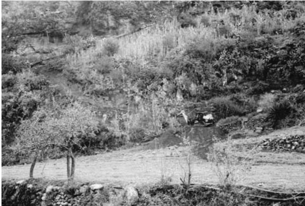
Imagen de un tractor destruyendo parte del Parque Rural de Doramas en Valsendero, para la apertura de una pista (Valleseco). Mario S. Marrero Arencibia
